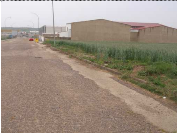
Estado actual de los Acerados. Polígono Industrial Ituci. Escacena del Camp
